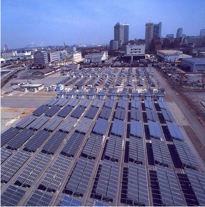
Kansai Solar Power 關西電廠 (Japan)
